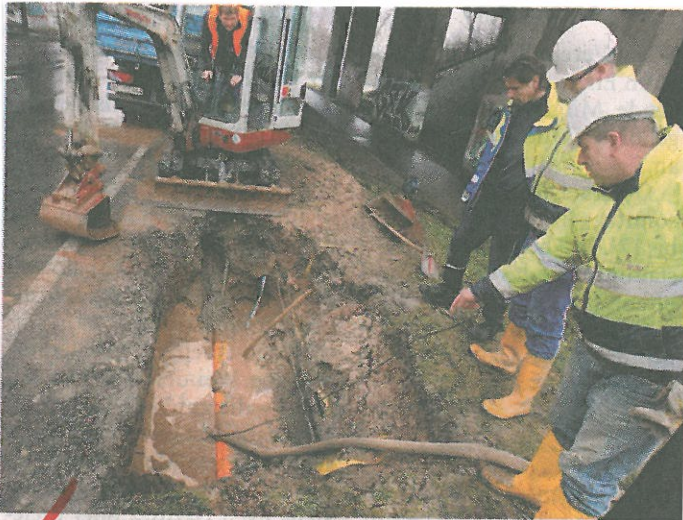
Das Rohr liegt frei: Handwerker des Spenger Unternehmens PRT Rohrtechnik und von der EWB begutachten das Wasserleck.
